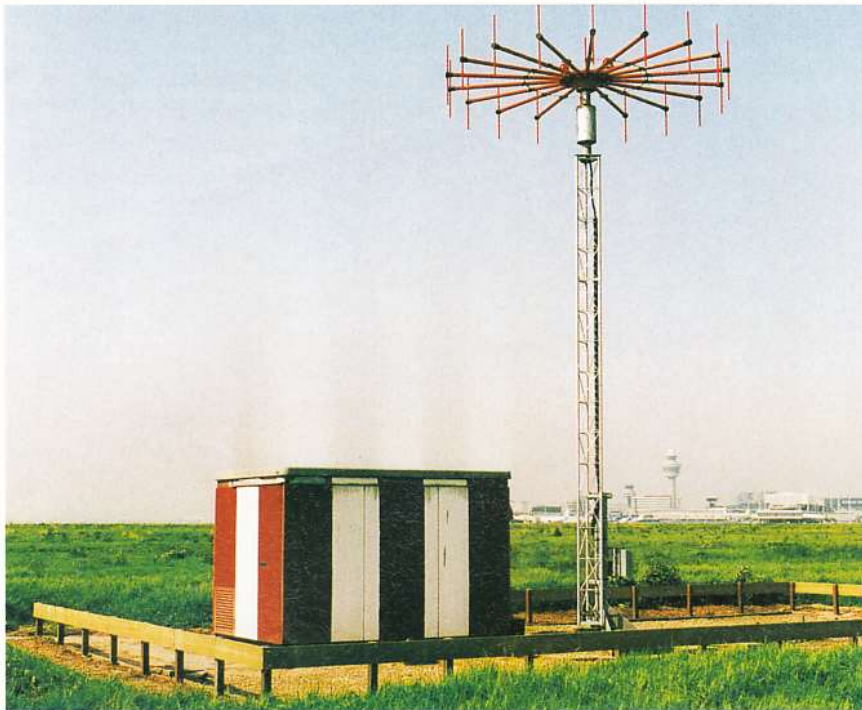
Radiopeiler. Er staan er zes in Nederland plus plaatselijke, zoals deze bij Schiphol.
